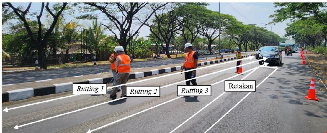
Gambar 9. Kerusakan Rutting dan Retakan di Lapangan
