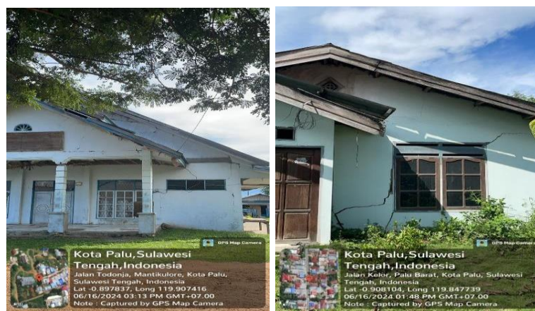
Gambar 5. Dampak kerusakan bangunan pasca gempa bumi 28 September 2018 untuk wilayah PGA rendah (kiri) dan PGA tinggi (kanan)
