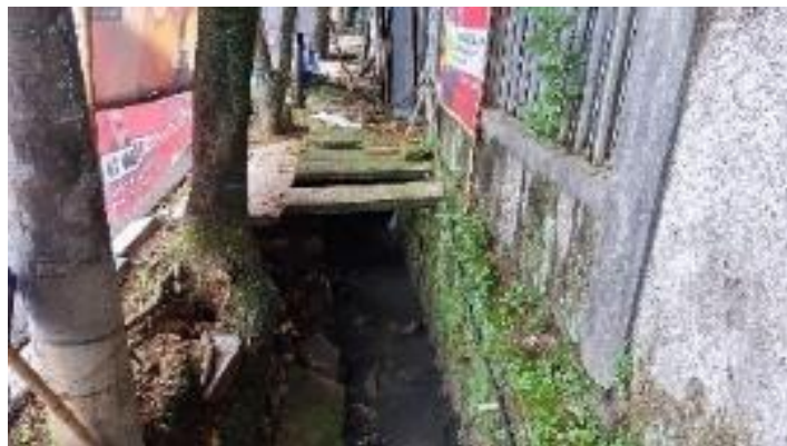
Gambar 3. Kondisi Fisik Jalur yang Terputus
