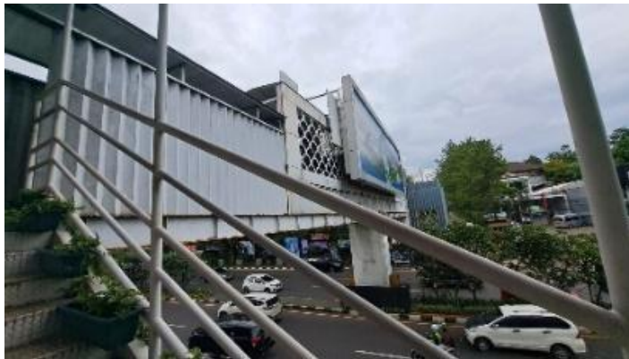
Gambar 4. Kondisi Fisik Jembatan Penyeberangan
