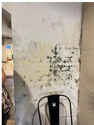
Gambar 2. Kondisi tembok lembab di Pos Bloc
