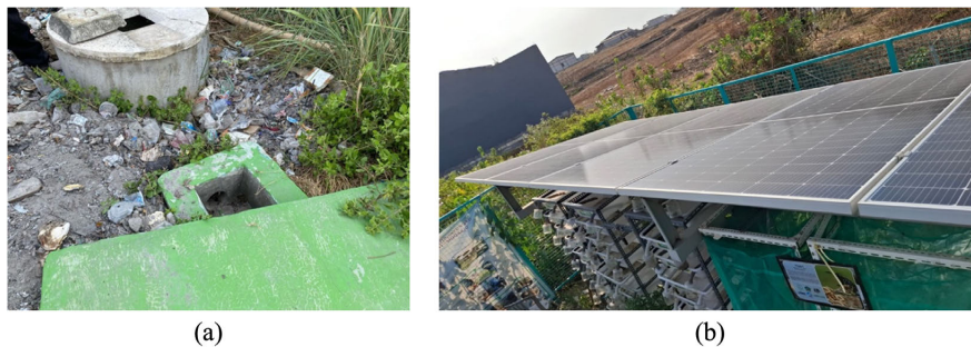
Gambar 1 Kondisi eksisting di TPS3R Sopo Nyongko (a) reaktor biogas dan (b) panel surya terpasang.
