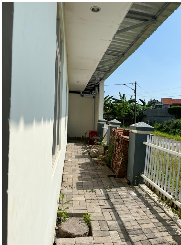
Gambar 1 Kondisi Awal (belum tersedia toilet).
