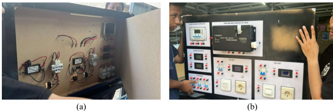
Gambar 6 Sistem PLTS; (a) Instalasi Modul PLTS; (b) Komponen Sistem PLTS.
