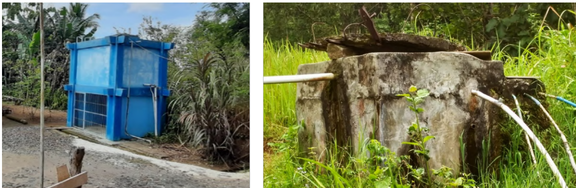
Gambar 4 Tandon air PAMDES system dan distribusi air bersih.
