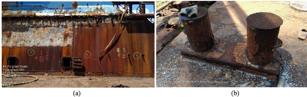
Gambar 2 Korosi pada (a) Wingwall & (b) Capstan .
