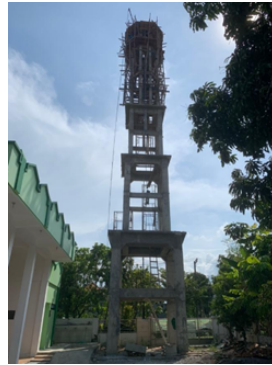
Gambar 1 Kondisi awal Menara Masjid Baiturrohiem.
