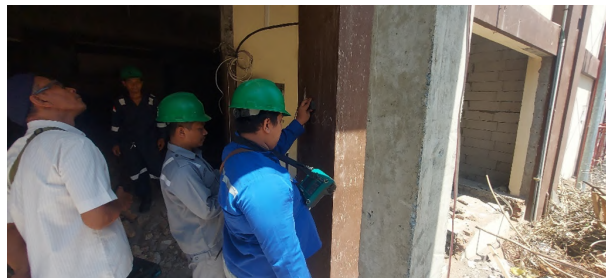
Gambar 1 Inspeksi visual di lapangan.
