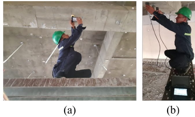
Gambar 4 (a) Pelaksanaan pengujian lebar retak, (b) Pelaksanaan pengujian kedalaman retak.
