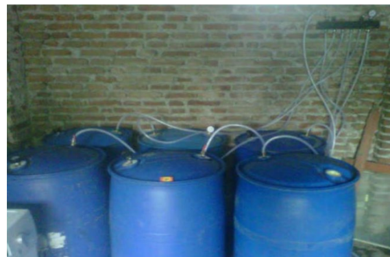
Gambar 17. Ilustrasi 6 buah drum yang sudah terpasang selang plastik dan pipa pengumpul biogas.
