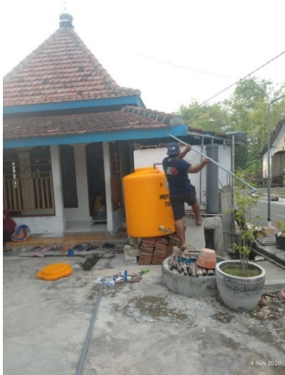
Gambar 8. Instalasi filter air di salah satu fasilitas umum (mushola) di Desa Sumberwudi Karanggeneng Lamongan
